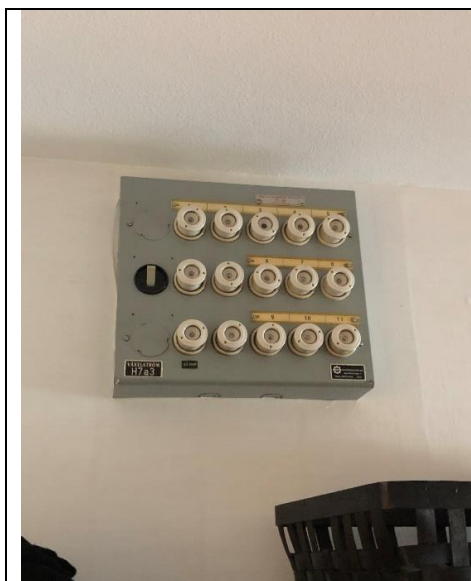
El-central med porslinsäkringar, saknar jordfelsbrytare.
