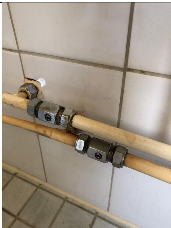
Otåta rörgenomföringar i vägg. Gamla Ballofixventiler..
