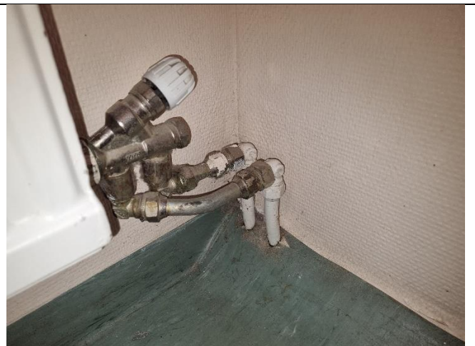
Rör genomföringar i golvvinkel.
