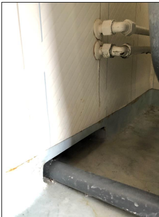
Rörgenomföring i plats för bad. Ursprunglig väggbrunn.
