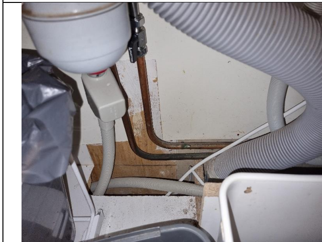
Otät skåpsbotten, kan ta lång tid innan en vattenskada upptäcks.
